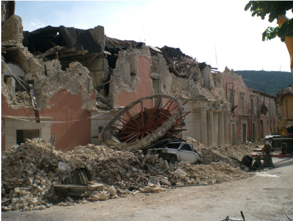
L'edificio distrutto della Prefettura de L'Aquila
